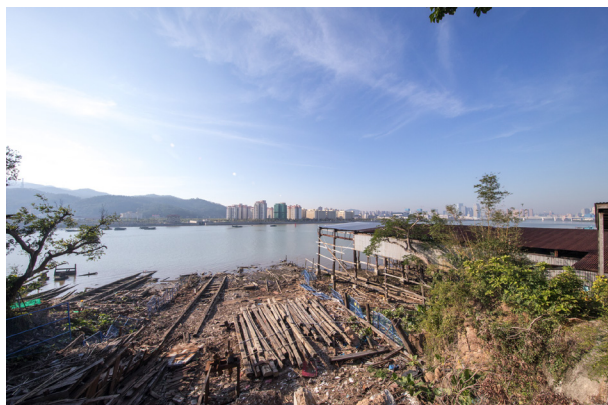
图 6.8：第 X-3 号船厂倒塌清理后之近况。
