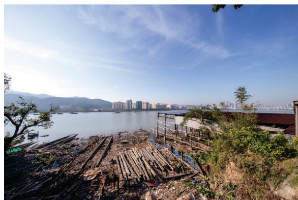
圖 6.8：第 X-3 號船廠倒塌清理後之近況。
