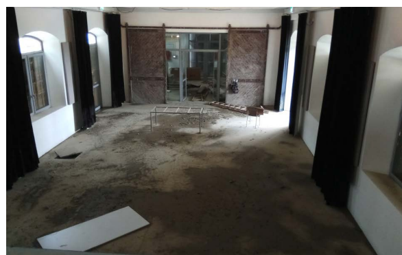
海事工房2號在風災後的受損情況
