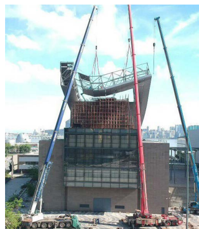
被嚴重吹毀的文化中心劇院大樓天面桁架
