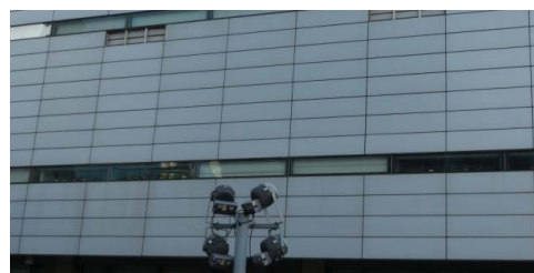
藝博館外牆鋁板脫落
