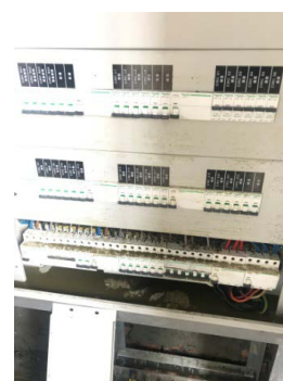
電力設備被海水淹浸，水退後仍留有泥濘。
