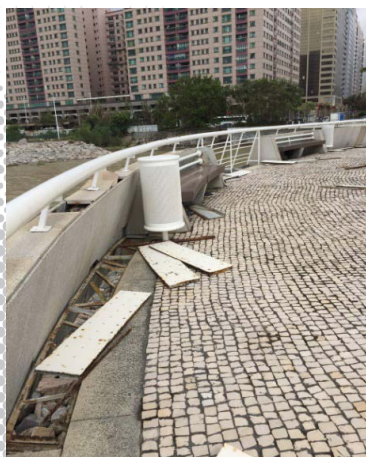
颱風過後觀音蓮花苑外圍受損狀況
