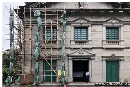
颱風後巡查文物建築及文化設施
